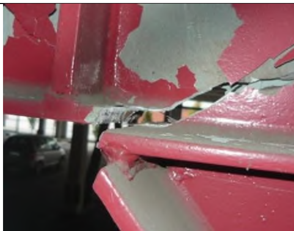
Пример образования трещин на приопорном участке балки
