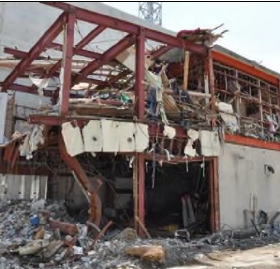
Пример обрушения части здания
