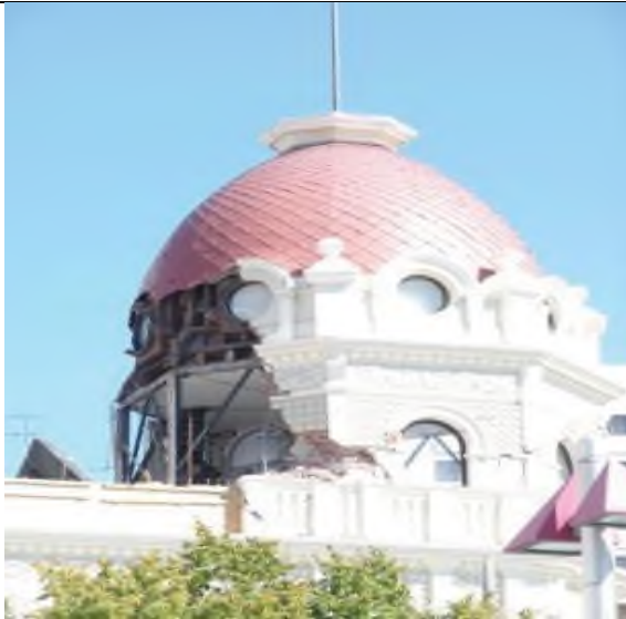
Пример обрушения элементов ограждающих конструкций
