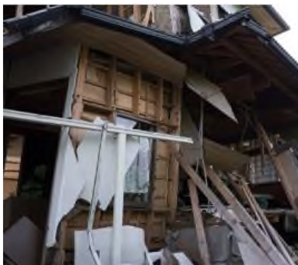
Пример разрушения обшивок
