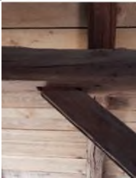
Пример разупрочнения соединения и раскрытия швов в соединении
