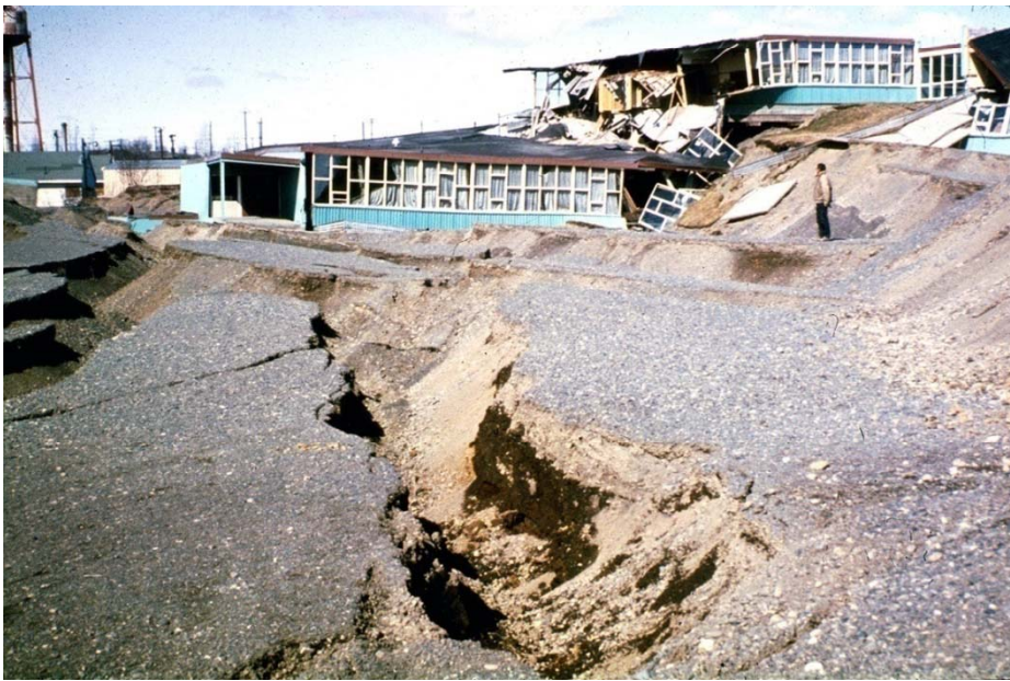
Анкоридж: Разжижение грунта при Землетрясении 27 марта 1964 г. M = 9.1
